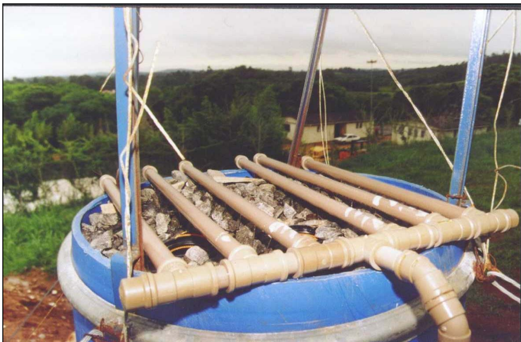
Figura F.31 – Sistema de gotejamento de lixiviado no filtro aeróbio, composto por 6 canos de PVC perfurados
