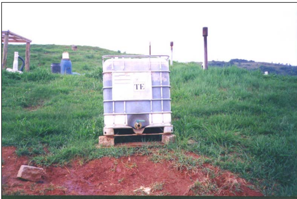
Figura F.22 – Tanque de estocagem de lixiviado bruto utilizado na Fase A da pesquisa
